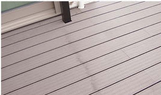
雨染みの発生したデッキ表面
